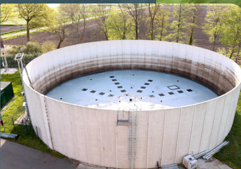
Atdekkingen voor biogasvergisters
